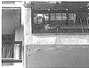
バルコニー鼻先周りのコンクリートモルタルの浮きと剝離。
