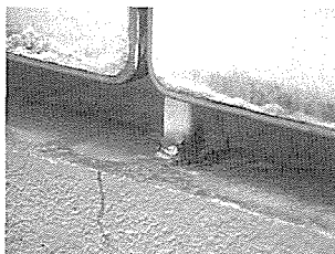
バルコニー手摺り支柱のコンクリート埋込み部の傷み。
