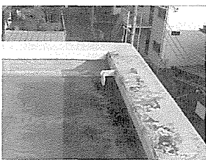
屋根パラベット周りと屋根防水面の傷み、補修跡。
