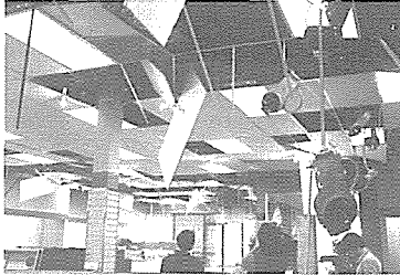
写真17 スプリンクラーが壊れて天井から水が漏れる事例は多い。
