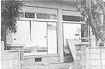
写真1-6 窓ガラスの被害
