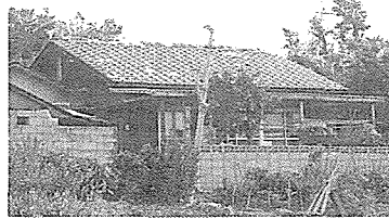
写真1-3 屋根葺材の被害
