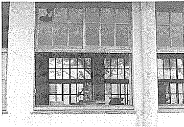
写真1-5 窓ガラスの被害
