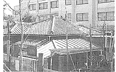
写真1-2 屋根葺材の被害
