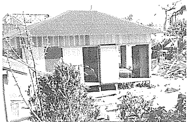
写真1-9 外壁開口部の被害
