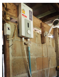
①浴室内の電気温水器
