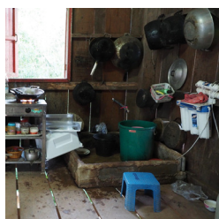
②台所棟に設置された水道
