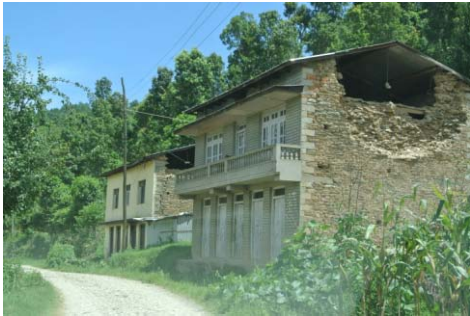
組積妻壁の被害
