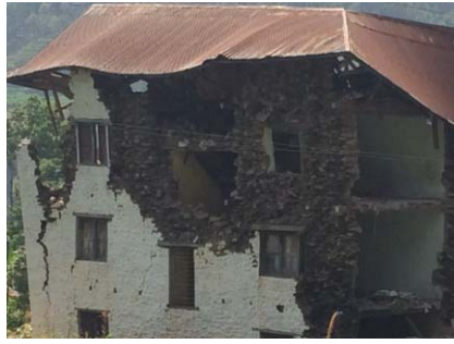
組積壁内部の剥離
