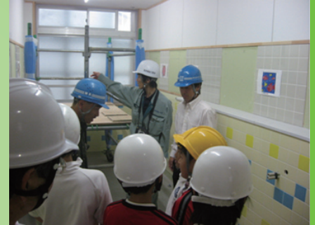
職人さんに教えてもらいながら、壁に施工する体験をする
