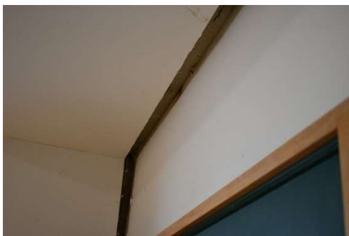
写真 2-5 倒れかかった間仕切り壁の例 (2021年の福島県沖を震源とする地震、学校施設)
