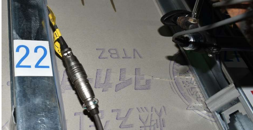
写真 5-12 下張りボードのひび割れ (表 5-10 中(23)) (セット5の層間変形角 1/100rad 時)
