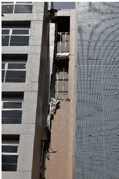
写真 2-9 ALC パネルの脱落の例（2022年の福島県沖を震源とする地震、商業施設）
