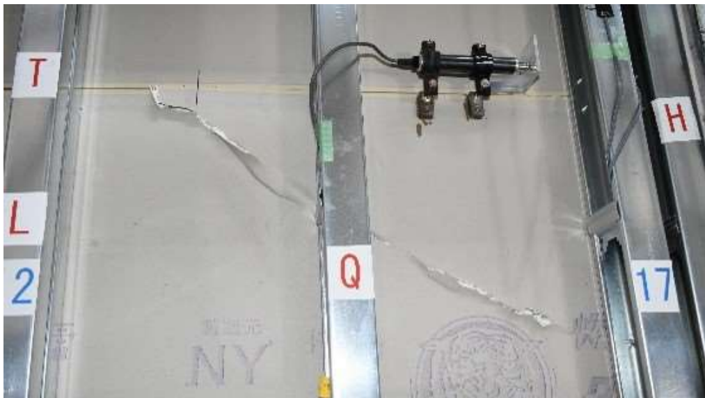
写真 5-9 下張りボードの破片の面外方向への傾斜 (表 5-9 中(14)) (セット 8 の層間変形角 1/40\text{rad} 時)
