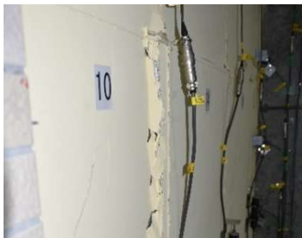
写真 5-5 上張りボードの面外方向への傾斜 (表 5-9 中(8)) (セット 6 の層間変形角-1/67rad 時)
