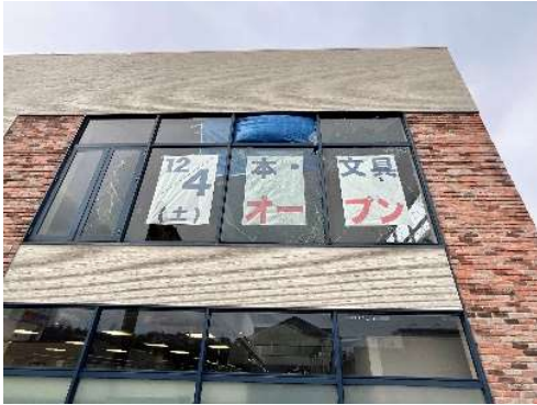
写真 2-17 ガラスのひび割れの例（2022年の福島県沖を震源とする地震、商業施設）
