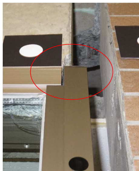
写真 5-29 2階のFIX窓の上枠の接合部の 隙間（160%加振後）
