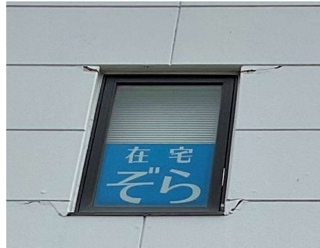
写真 2-8 ALC パネルの角部のひび割れの例（2022年の福島県沖を震源とする地震、商業施設）
