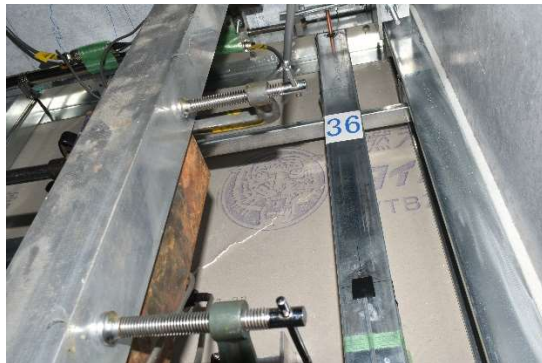
写真 5-13 下張りボードのひび割れ (表 5-10 中(25)) (セット7の層間変形角 1/50rad 時)
