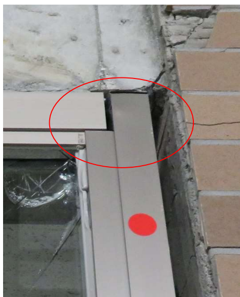
写真 5-28 3階のFIX窓の上枠の接合部の 隙間（160%加振後）
