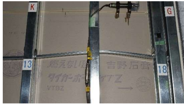
写真 5-8 振れ止めの変形 (表 5-9 中(13)) (セット 7 の層間変形角 1/50\text{rad} 時)
