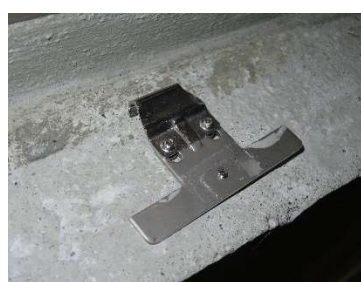
写真 5-36 3階の引き違い窓の脱落したクレセント受け（160%加振後）
