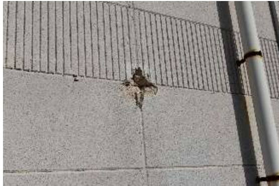
写真 2-7 ALC パネルの角部のひび割れの例（2021年の福島県沖を震源とする地震、商業施設）
