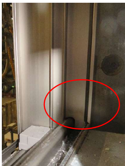
写真 5-40 3階の引き違い窓の縦枠の内部 の変形（160%加振後）
