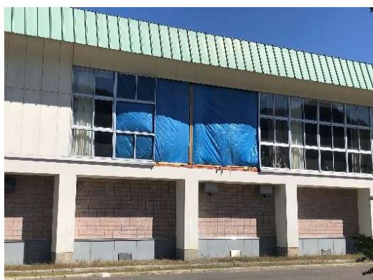
写真 2-11 窓の脱落の例（2018年の北海道胆振東部地震、学校施設）
