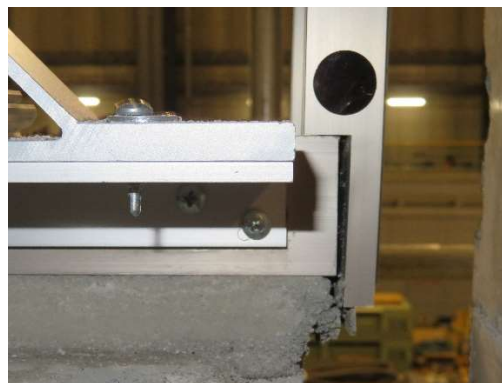
写真 5-43 2階の引き違い窓の下枠と縦枠との接合部の隙間（160%加振後）
