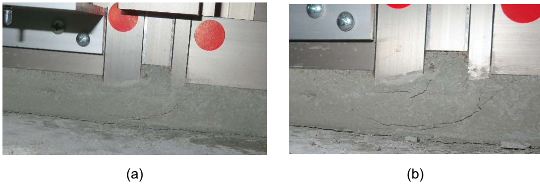
写真 5-47 3階のFIX窓の方立の直下のモルタルのひび割れ; (a) 150% (1回目) 加振後, (b) 160%加振後
