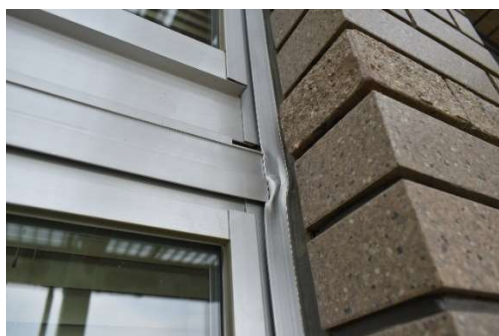
写真 2-13 窓の枠の変形の例（2021年の福島県沖を震源とする地震、学校施設）
