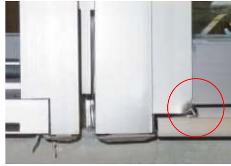
写真 5-25 2階のFIX窓の縦枠の角部の変形（160%加振後）
