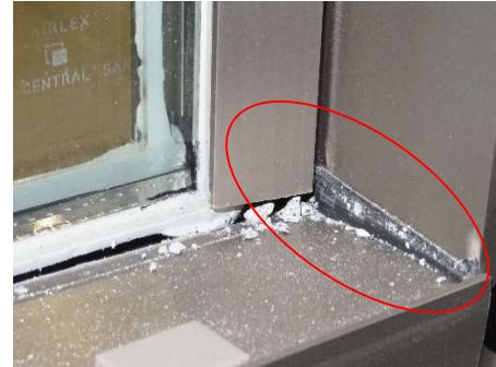
写真 5-27 2階のFIX窓の下枠の変形（160%加振後）
