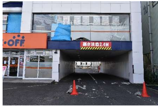
写真 2-18 ガラスのひび割れの例（2022年の福島県沖を震源とする地震、商業施設）
