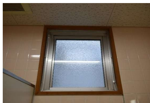
写真 2-14 窓の枠の変形の例（2021年の福島県沖を震源とする地震、学校施設）
