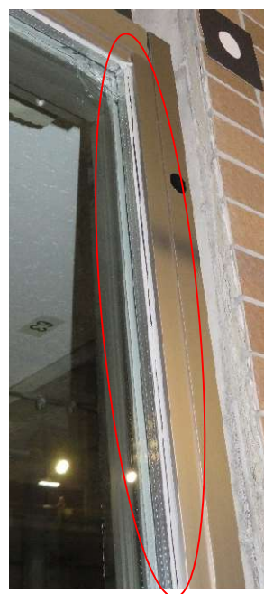
写真 5-32 2階のFIX窓の縦枠とガラスの間の端部のシーリング材の切れ（160%加振後）
