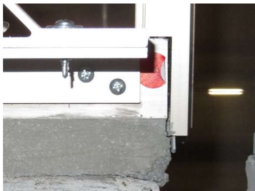
写真 5-42 3階の引き違い窓の下枠と縦枠との接合部の隙間（160%加振後）
