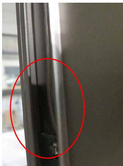
写真 5-41 2階の引き違い窓の縦枠の内部 の変形（160%加振後）
