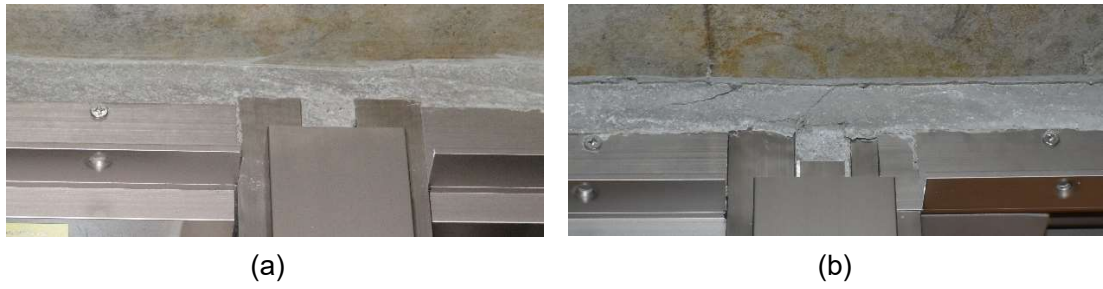
写真 5-46 2階のFIX窓の方立の直上のモルタルのひび割れ; (a) 150% (1回目) 加振後, (b) 160%加振後
