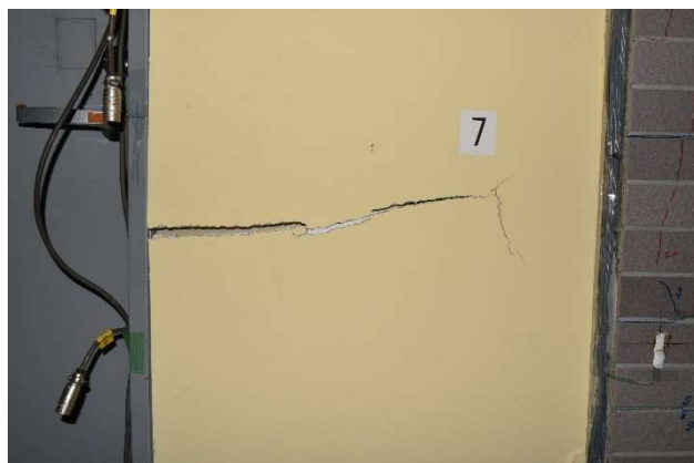
写真 5-15 上張りボードの面外方向への傾斜 (表 5-10 中(27)) (セット 8 の層間変形角 1/40rad 時)
