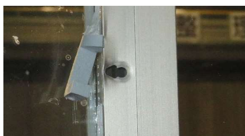
写真 5-35 3階の引き違い窓のクレセント受けが外れた召合わせ框（160%加振後）
