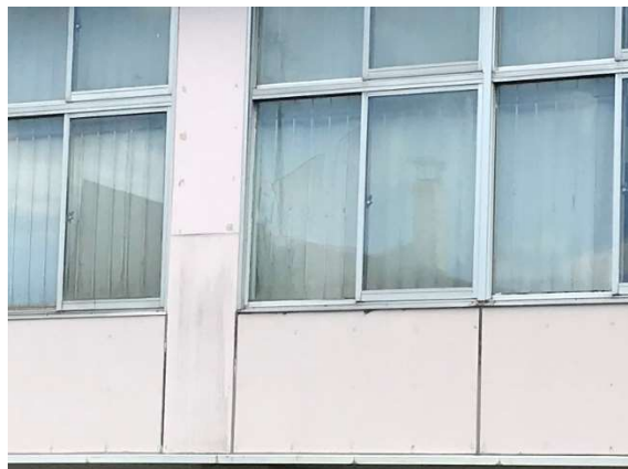
写真 2-12 ガラスのひび割れの例（2018年の北海道胆振東部地震、学校施設）
