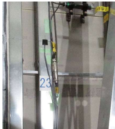
写真 5-16 振れ止めの変形 (表 5-10 中(28)) (セット 8 の層間変形角 1/40rad 時)
