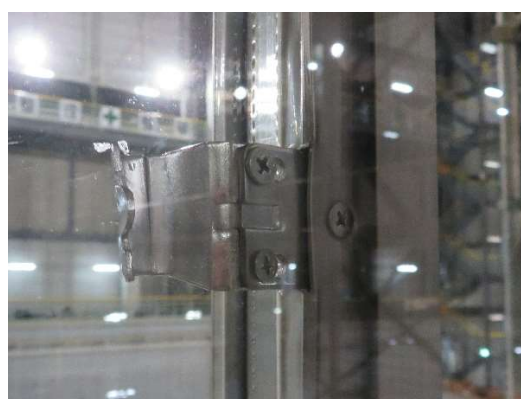
写真 5-34 2階の引き違い窓の変形したクレセント受け（160%加振後）
